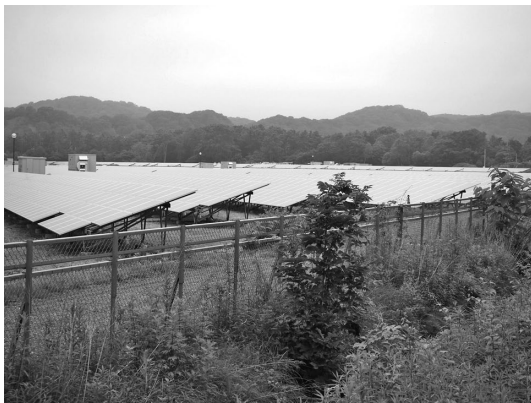
町内に設置されている太陽光発電
