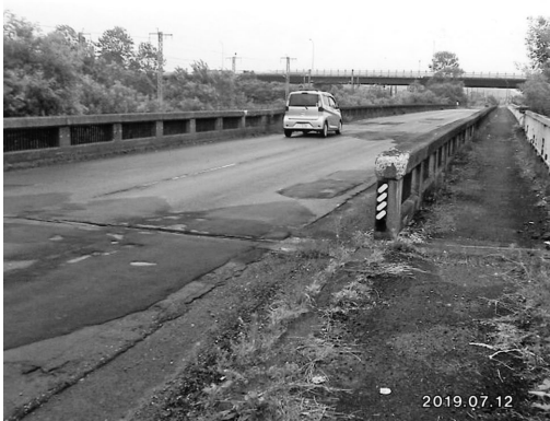
耐用年数を超過している白老大橋
