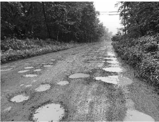
整備が求められる町道石山1番通り
