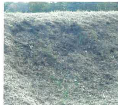
土塁の崩落状況（雨水など）
