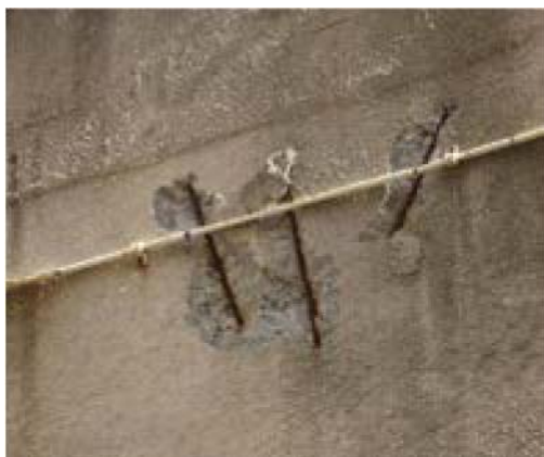
鉄筋の発錆状況【南側庁舎】
