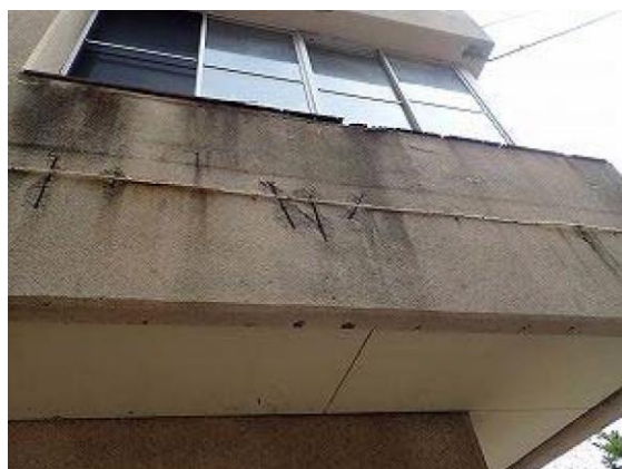
鉄筋の発錆状況【南側庁舎】
